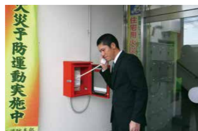
▲白石消防署の玄関前に設置してある通報装置
