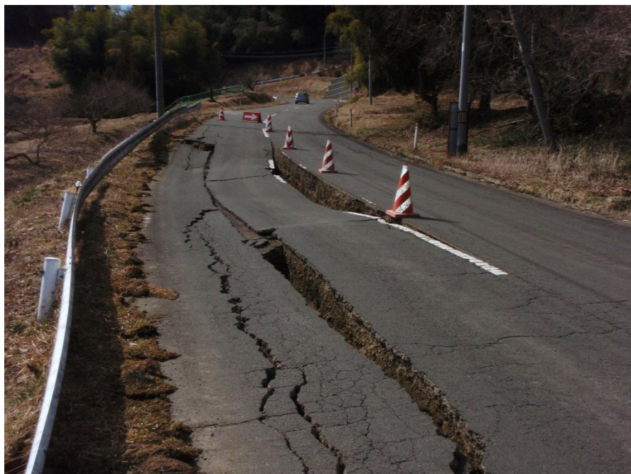
白石市内の地震被害の様子
